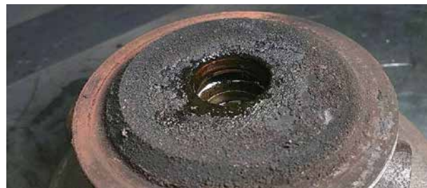
Photo 7 - L'accumulation de calamine du côté turbine du logement du palier est également le résultat d'une chaleur extrême
