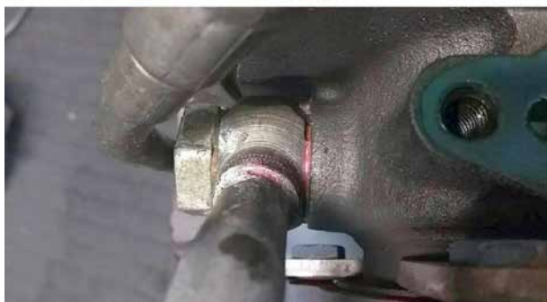
Photo 1 + 2 - Les fuites de liquide de refroidissement sont visibles au niveau du raccord de la conduite de liquide de refroidissement
